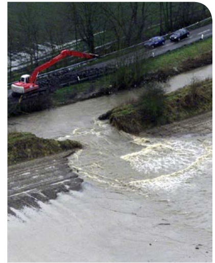
Rupture de la digue de l'Hogneau
